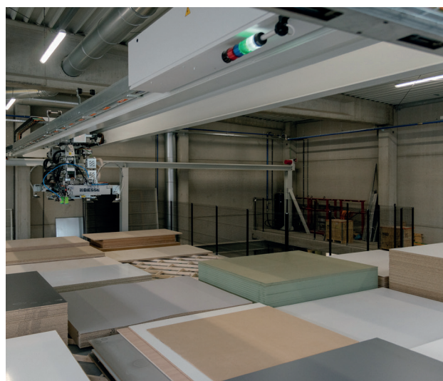
Het nieuwe automatisch platenmagazijn op verdieping (met onderliggend de opdeelzaag).
